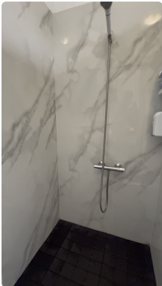
Общ изглед · Облицовката около душа и съседната стена.
